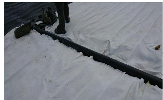
Connexion des mini-drains du DRAINTUBE 300P TF1 D20 au drain collecteur des biogaz au moyen du système Quick Connect.
