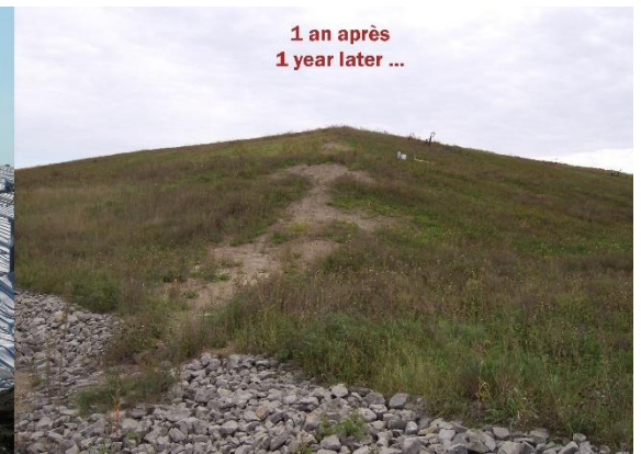
Drainage des eaux de pluies sur géomembrane - 2009 Rainwater drainage on a cap - 2009
