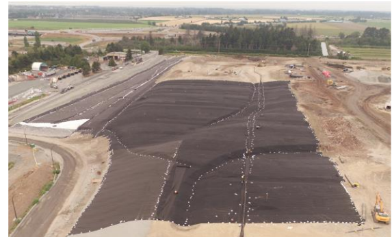
Installation du DRAINTUBE 606 ST2 D25 pour extraire le gaz sous la géomembrane. Chaque panneau de DRAINTUBE® est connecté au drain principal avec les Quick Connect System.
