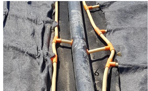
La technologie Quick Connect System est utilisée pour réduire l'intrusion d'air et permettre l'extraction du gaz par pression négative.
