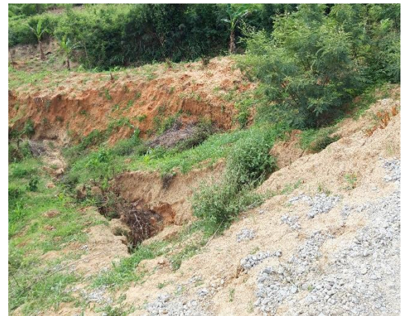
Effondrement des talus après période humide
