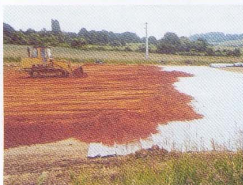
Photo 3 Remblaiement sur le géocomposite et montée du remblai Backfilling over the geocomposite and rising of the embankment
