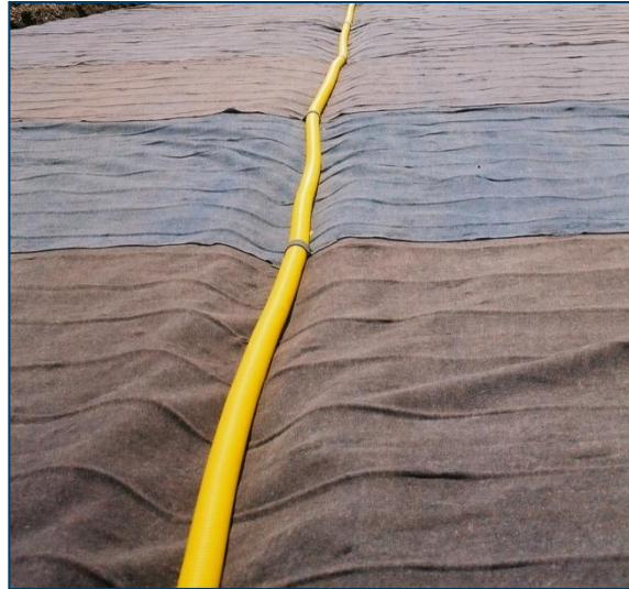
Figure 12: Raccordement au drain de captage des gaz
